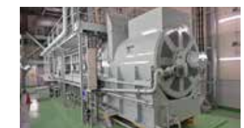
東京中城八重洲內能源中心
