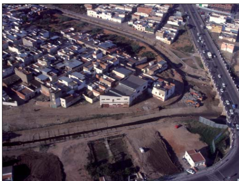
Fig. 33. Obras para la retirada de las viviendas siniestradas en la inundación del río Rivillas (Badajoz), que taponaban varios ojos de un importante puente (Fotografía: Jose A. Ortega).
