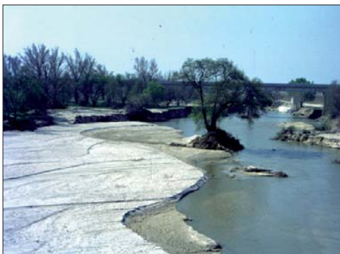
Fig. 29. Efectos de las graveras en el río Guadarrama. Intensa erosión en las márgenes y encajamiento remontante del río que afectó a una estación de aforo y socavación de varios puentes (Fotografía: G. Garzón).
