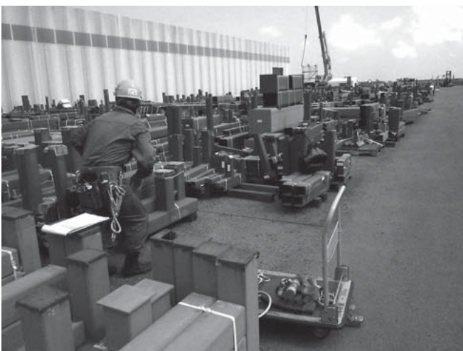
図2 | 建設サイトの倉庫
