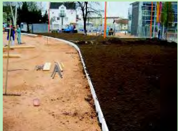
Syflex® como elemento creativo en la Exposición de Jardinería Paisajista de 2004 en Burghausen.
