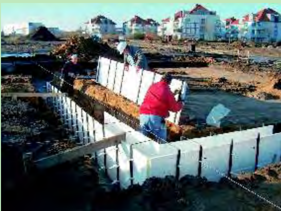
Syflex® para cimentación continua. 5m 2 de encofrado se desplazan sin ningún equipo de elevación.
